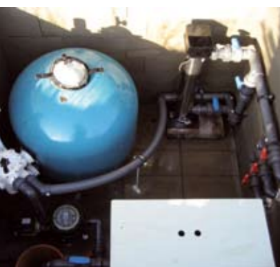
En teknikstation bestående af et mekanisk sifilter nederst til højre, en tørmonteret pumpe nederst til venstre og et Beadfilter øverst til venstre. Øverst til højre ses et UV-lys til bekæmpelse af sygdomsfremkaldende vira og bakterier. I midten til højre ses tre returløb, hvorfra vandet ledes tilbage til svømmesøen. Teknikstationen kan skjules f.eks. under en træterrasse.
